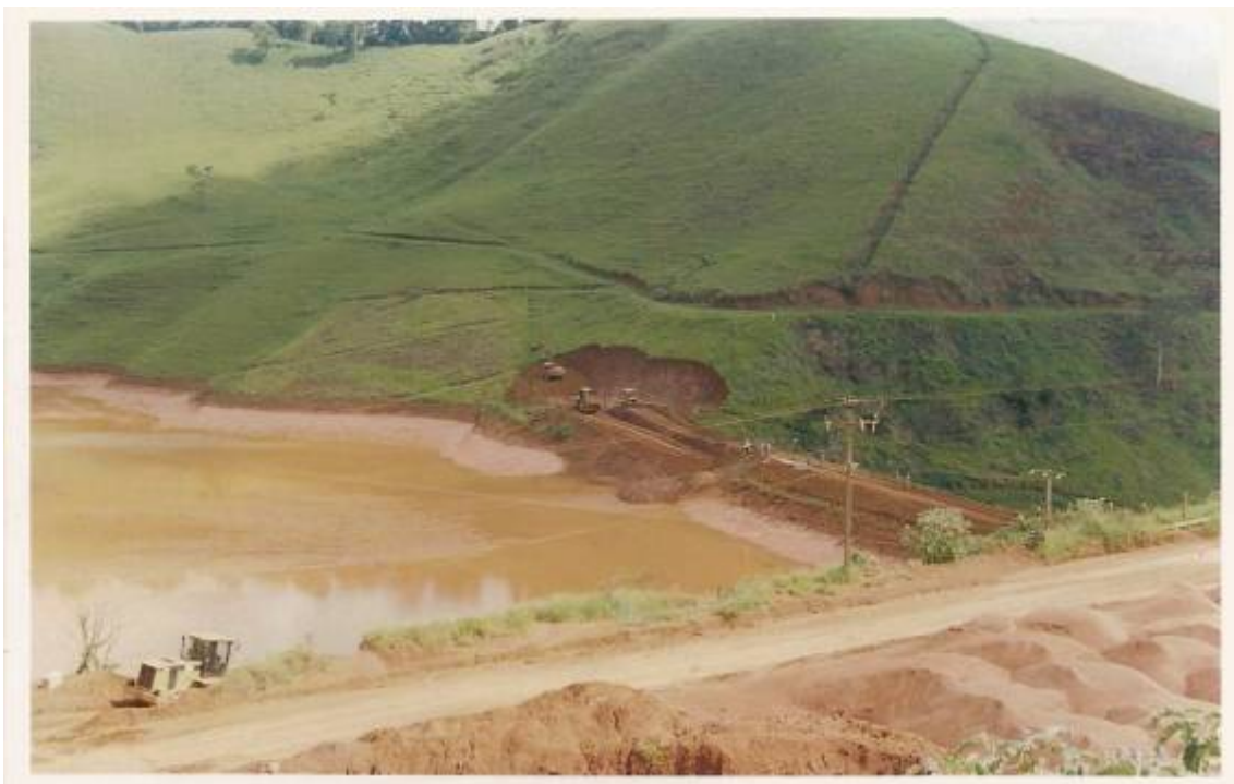
Figura 1 - Barragem rompida na Mineração Rio Pomba Cataguases em Mirai – MG.
